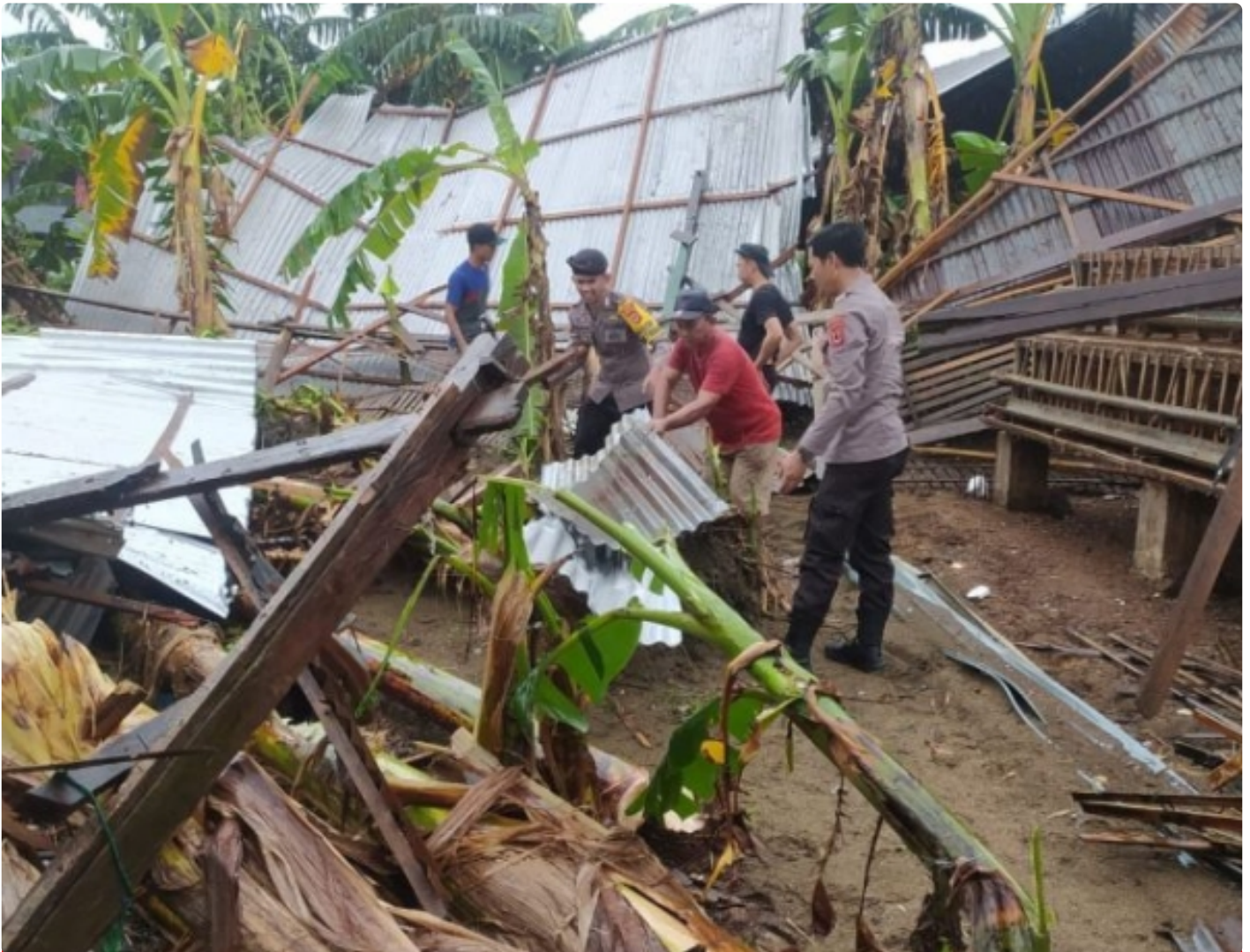
Bangunan rumah peternakan ayam milik warga Polejiwa roboh rata dengan tanah usai diterjang angin puting beliung
