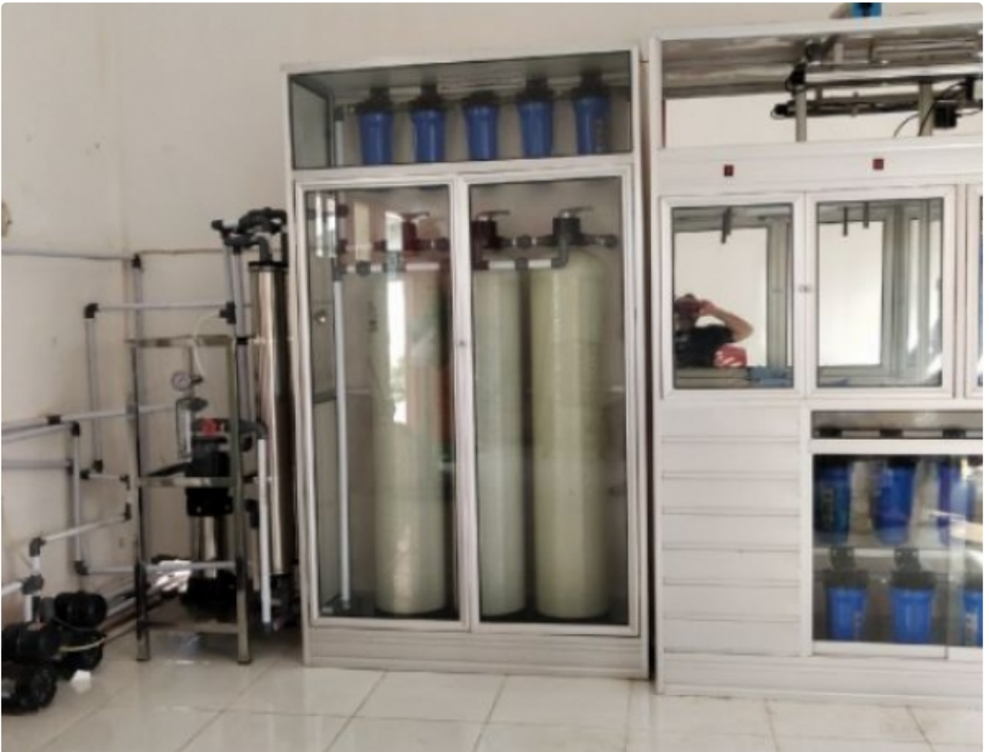
Bumdes Desa Corawali Buka Depot Air Isi Ulang
