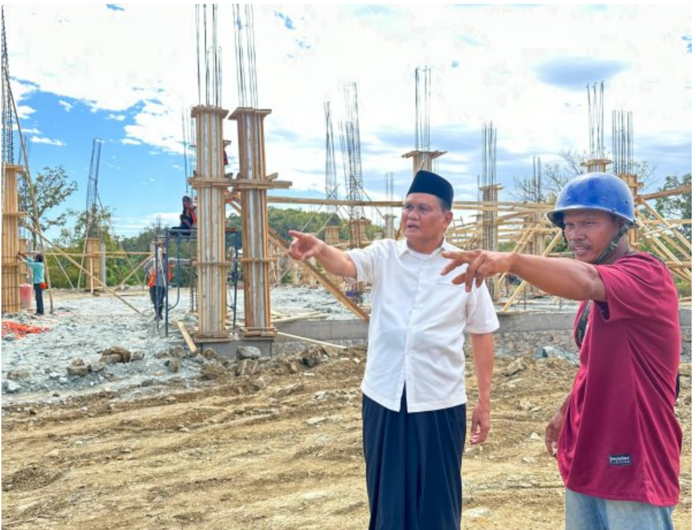
Bupati Barru, Dr (HC), Ir. H. Suardi Saleh, M.Si, secara langsung memantau perkembangan pembangunan Masjid Raya Kabupaten Barru
