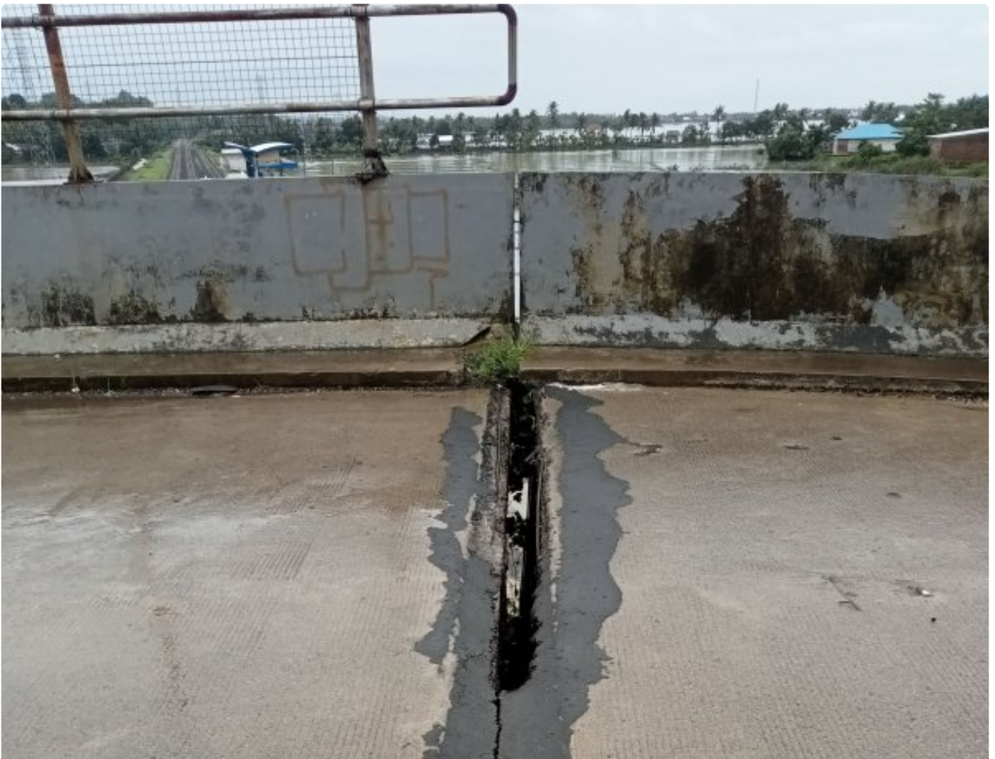
Sambungan jalan fly over Pekkae rusak parah
